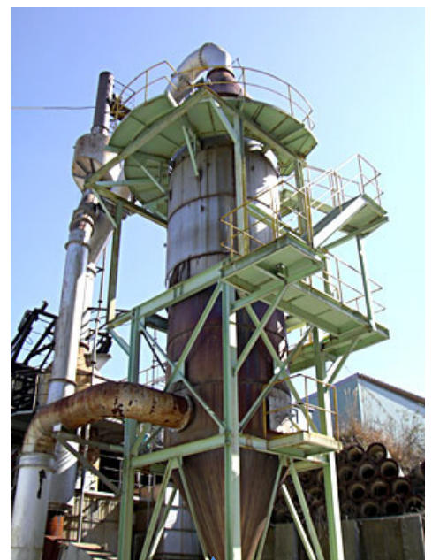
中間処理 焼却施設
